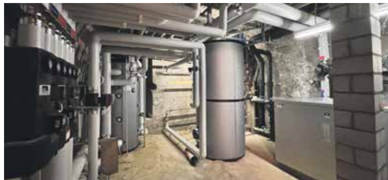
Heizung im Haupthaus.
