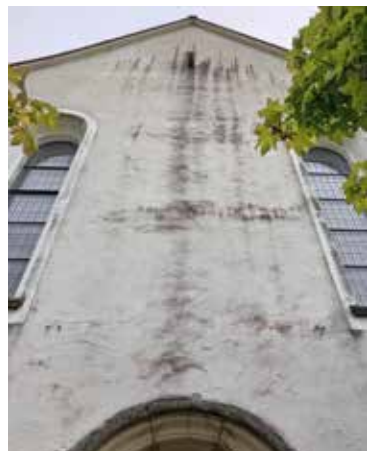
Die mit Rotalgen befallene Fassade beim Seiteneingang.
